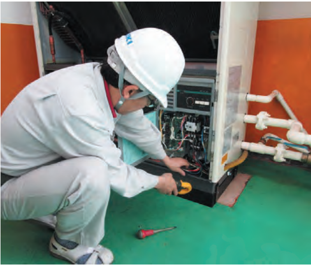
冷媒フロン機器の定期点検
