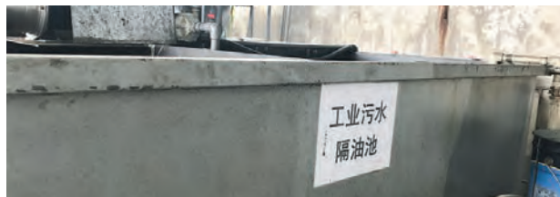
最終排水処理設備
