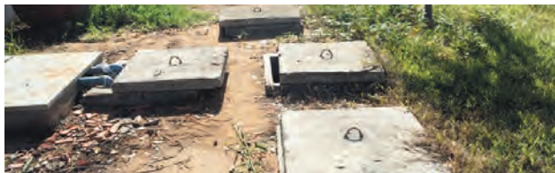
JUKIベトナム(株)第二工場処理システム
