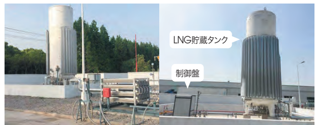
LNGガス化ステーションの内部エリア写真
