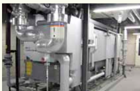
ガス吸収式冷温水機
