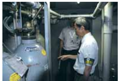
安全巡視でハロンポンプ室をチェックしている
